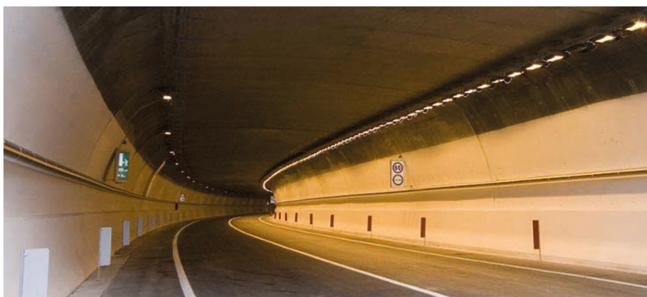
AUTOSTRADA DEI FIORI S.P.A. - Autostrada Dei Fiori Tunnel Lighting
