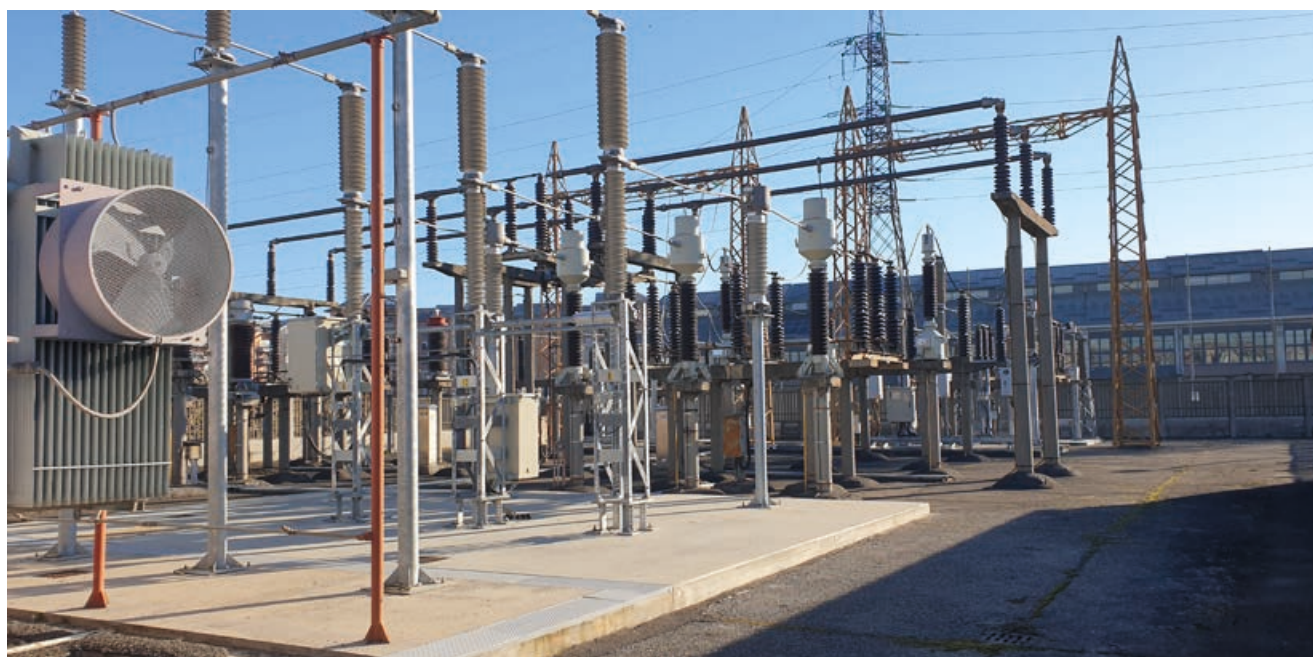
OLON S.P.A - New electrical cabin, Settimo Torinese
